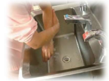
<給食調理場の手洗い設備>
